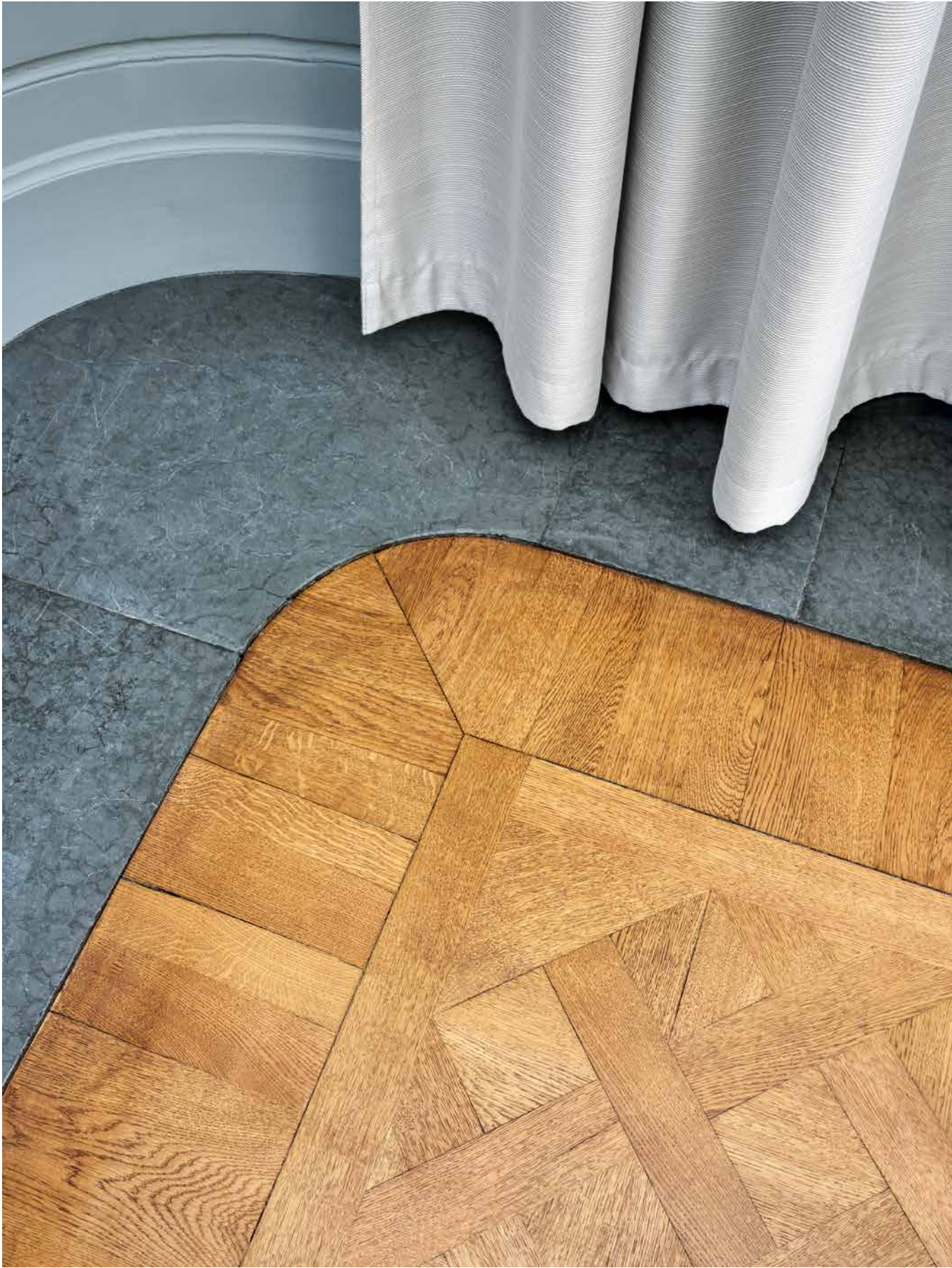
GOLV DRABBAS OFTA HÄRDAST VID RENOVERINGAR DÅ NYA DRAGNINGAR OCH INSTALLATIONER GÖRS. I JAKOB MINDRE 11 HAR EKPARKETTEN KLARAT SIG SKADESLÖS, LIKSOM DEN OMGIVANDE FRISEN AV KALKSTEN.
